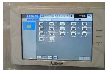
建替にともない電気制御システムを導入
